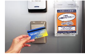
エントランスのセキュリティ
