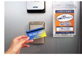
エントランスのセキュリティ
