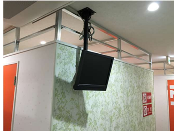
ハローストレージ宮野木プレミア 室内の監視モニター
