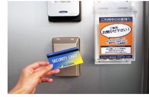
エントランスのセキュリティ
