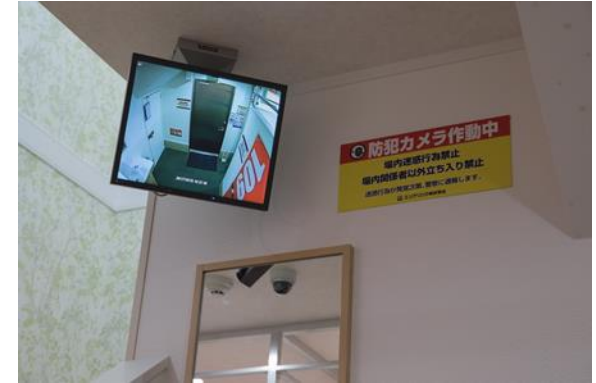
室内の監視モニター
