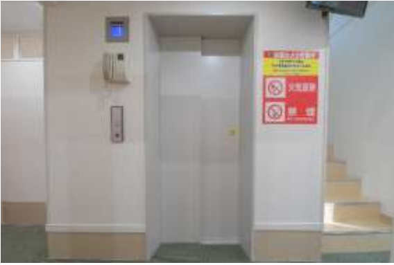
エレベーターを完備
